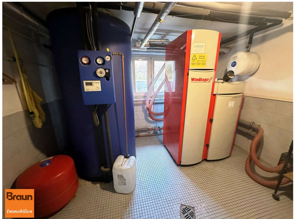
Wohnhaus, Deißlingen, 4-7274 Pellets-Heizung
